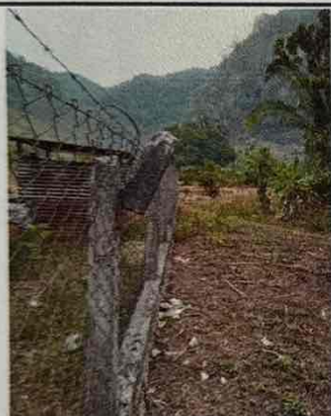
Se observa el mal estado de la malla en la circulación del predio.
