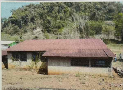
Se observa el deterioro del techo del establecimiento educativo
