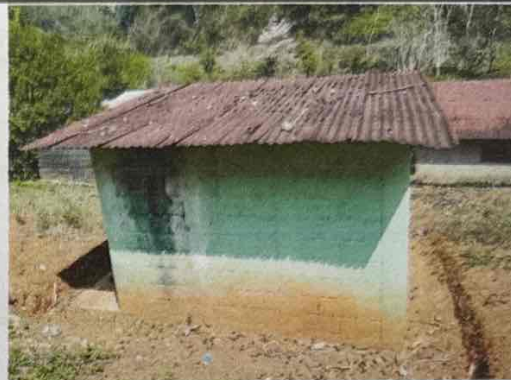
Se observa el deterioro de las laminas del techo del servicio sanitario.
