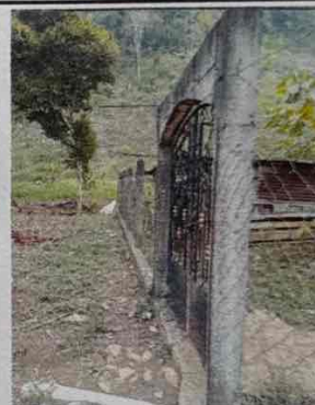
Se observa el mal estado portón de la entrada principal
